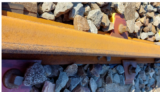
Illustration du rail oxydé AVANT passage du camion
